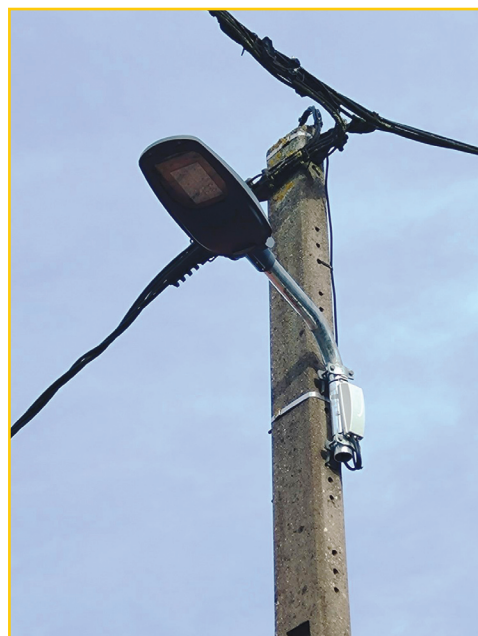
Les nouveaux luminaires LED de la commune
