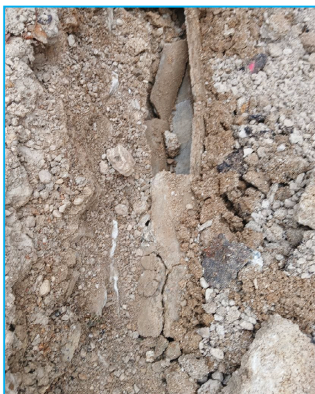
Le réseau d'eau pluviale effondré
